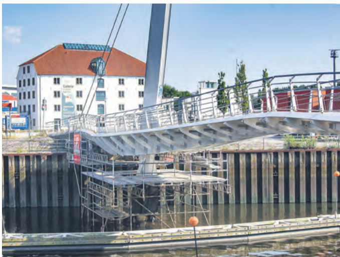
Die Brücke am Vegesacker Haven ist defekt. Größere Schiffe können nicht mehr ungehindert die Liegeplätze erreichen oder verlassen. Foto: th
